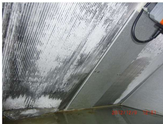
Figur 15 Exempel på batteri med påfrysning i värmeväxlaren, när det är kallt ute och man inte har en förvärmning etc. Bild från Bengt Bergqvist, Energianalys AB.
