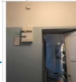
Tilluftsdorn i lgh 1002. Ingen kanaldragning
