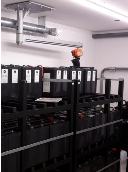
Figur 2: Batterilager, 144 kWh bly-kiselgel, i ett lågenergihus med önätsdrift. (Elsäkerhetsverket, 2016)
