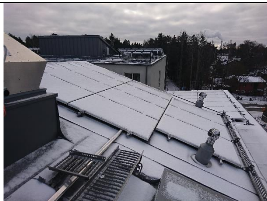
Solcellsanläggning på fläktrumstak.
