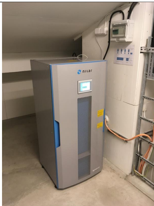
Nytt batterilager 17,3 kWh.
