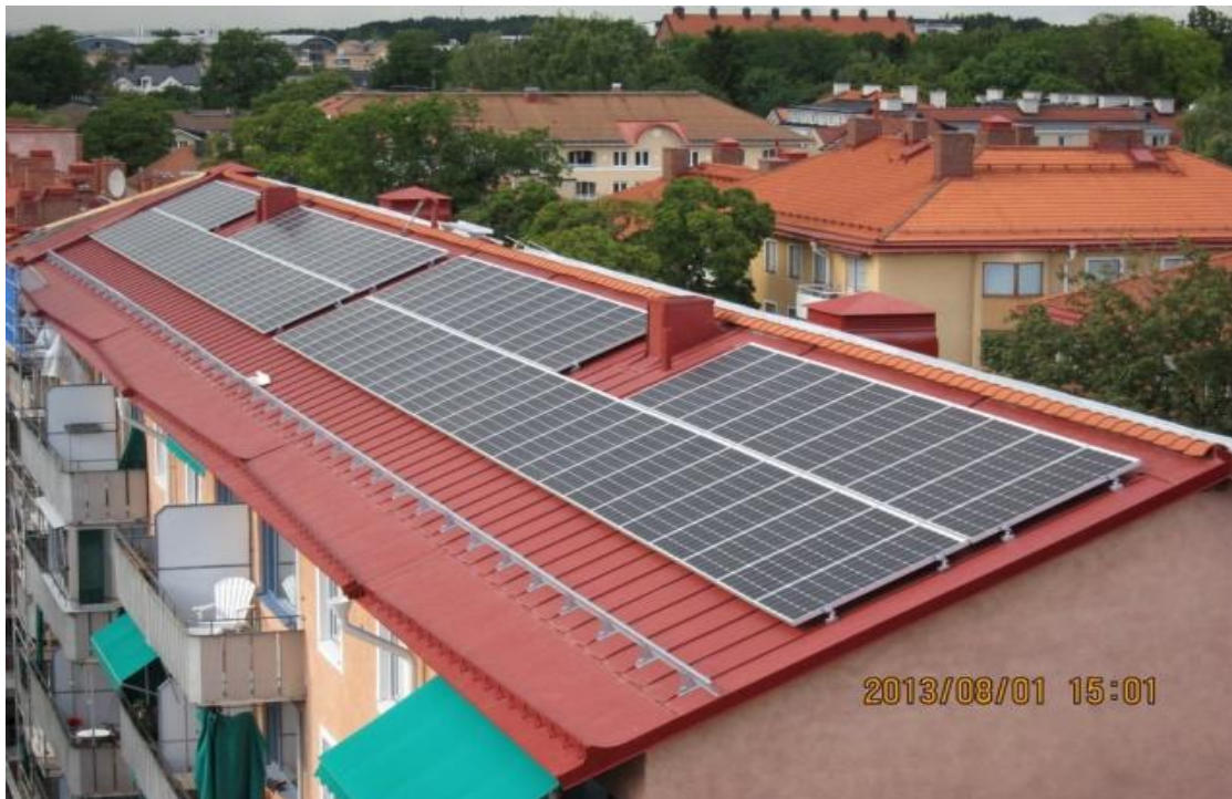
Figur 24: Solcellsanläggningen på BRF Granegården. Fotograf: Jan Lemming.
