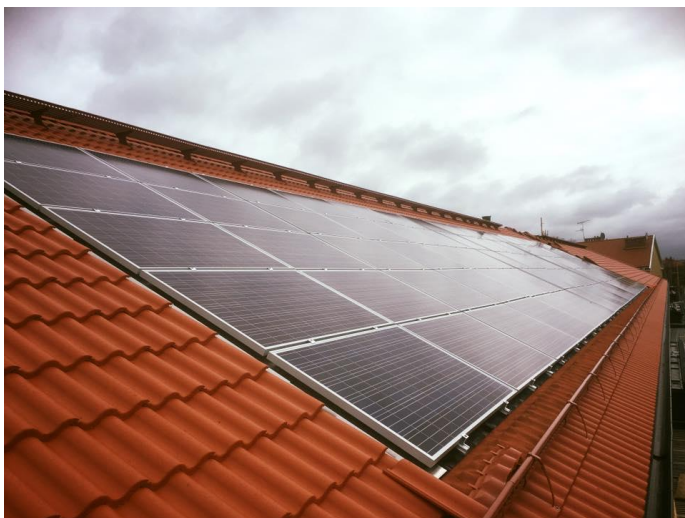
Figur 22: Solcellsanläggningen på en av BRF Krigarens taktytor. Foto: Nyedal solenergi.
