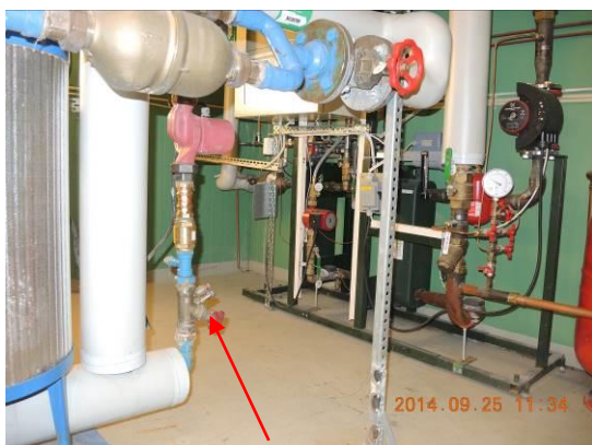
Bild 3. En av 2 st VVC-pumpar har STAD-ventil som möjliggör flödesmätning av VVC-flöde
