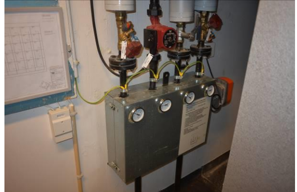
Bild 8. Shuntgrupper vid luftbehandlingsaggregat har STAD-ventil som möjliggör flödesmätning.
