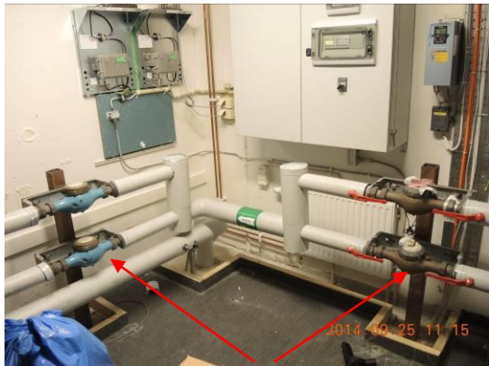
Bild 1. Dubbla kallvattenmätare i fläktrum Bergengatan 43 är seriekopplade med ytterligare dubbla mätare som mäter samma flöde.
