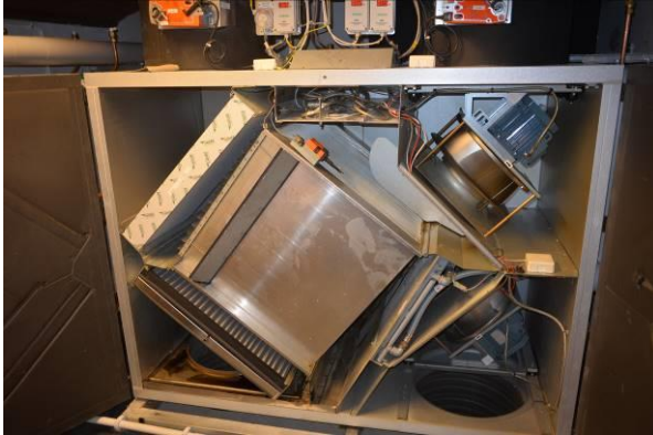
Bild 7. Befintligt FT-system har ersatts med FTX-system med värmeåtervinningsaggregat Exhausto typ VEX 100 med plattvärmväxlare.
