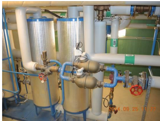
Bild 2. Dubbla varmvattenmätare i undercentral
