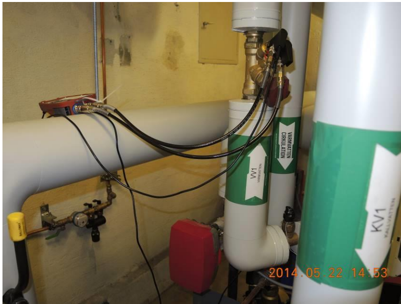
Bild 1.3. Loggning av VVC-förlusteffekt via VVC-flöde och temperaturdifferens mellan VV och VVC. (Rören är felmärkta – Märktejperna VV1 och VARMVATTENCIRKULATION har förväxlats)
