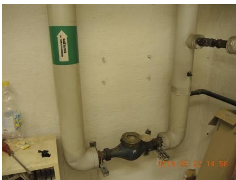
Bild 5. Vattenmätare för kallvatten till varmvattenberedning.
