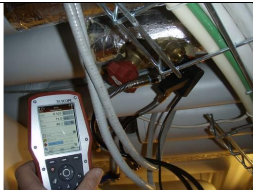
Bild 2.3. STAD-ventiler finns i 3 av 4 st vvc-kretsar.
