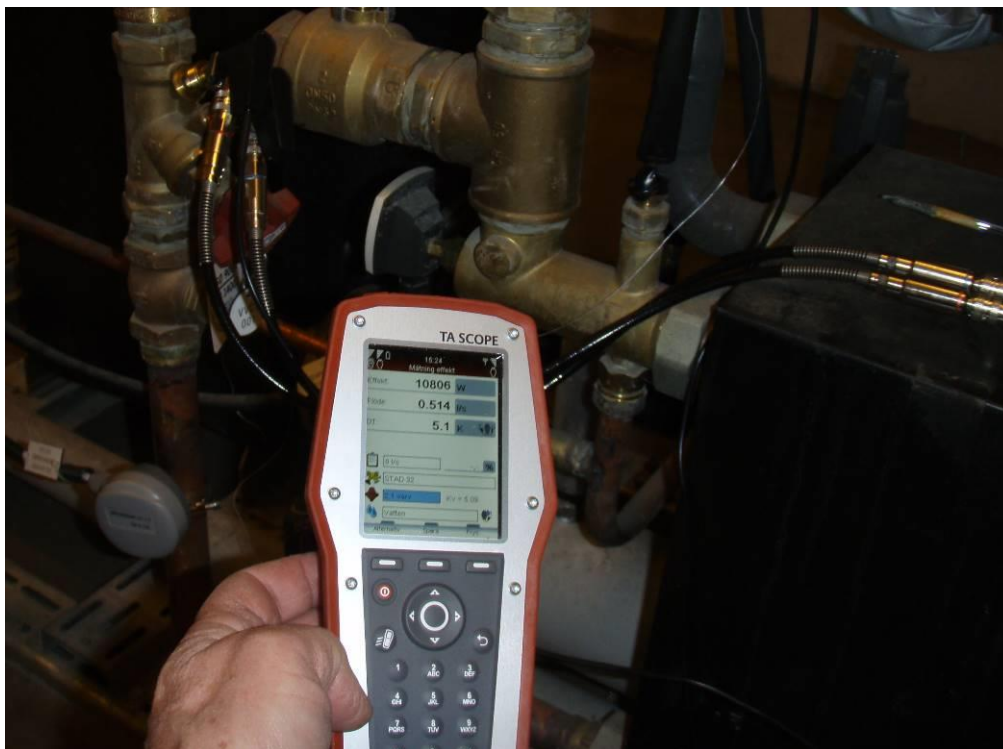
Bild 2.2. Resultat från momentanmätning; Värmeförlusteffekt: 11 kW, flöde 0,51 l/s, temperaturdifferens VV/VVC: 5,1°C.
