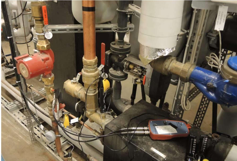
Bild 2.1. TA Scope med givare loggar flöde över STAD-ventil och temperaturer på VV och VVC. Tinytags –temperaturloggar loggar också temperaturer på VV och VVC. Märkeffekt på VVC-pump uppgår till 135 – 240 W.
