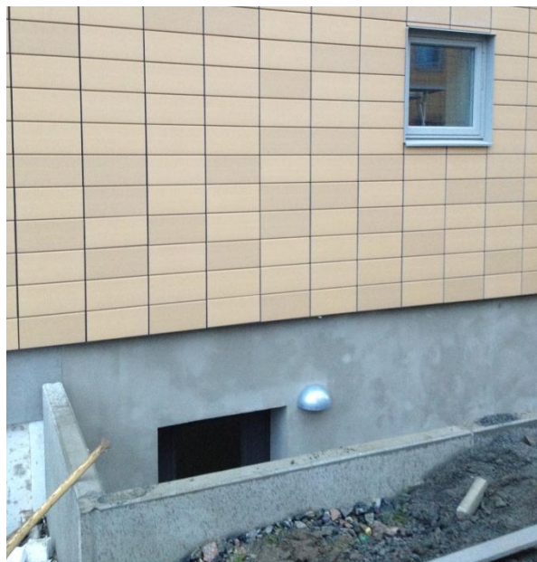
Figur 25 Utvändigt bild att jämföra med termogram 3-6 i Bilaga D, där en större köldbrygga syntes i golvinkeln
