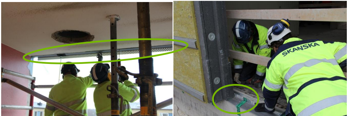
Figur 13 Tv: Borrning för infästning av vinkelprofil (inringad) på undersida vindsbjälklag, arbete över axelnivå. Th: Infästning av element till vinkelprofil monterad på ovansida bjälklag. Betydligt bättre arbetsställning.
