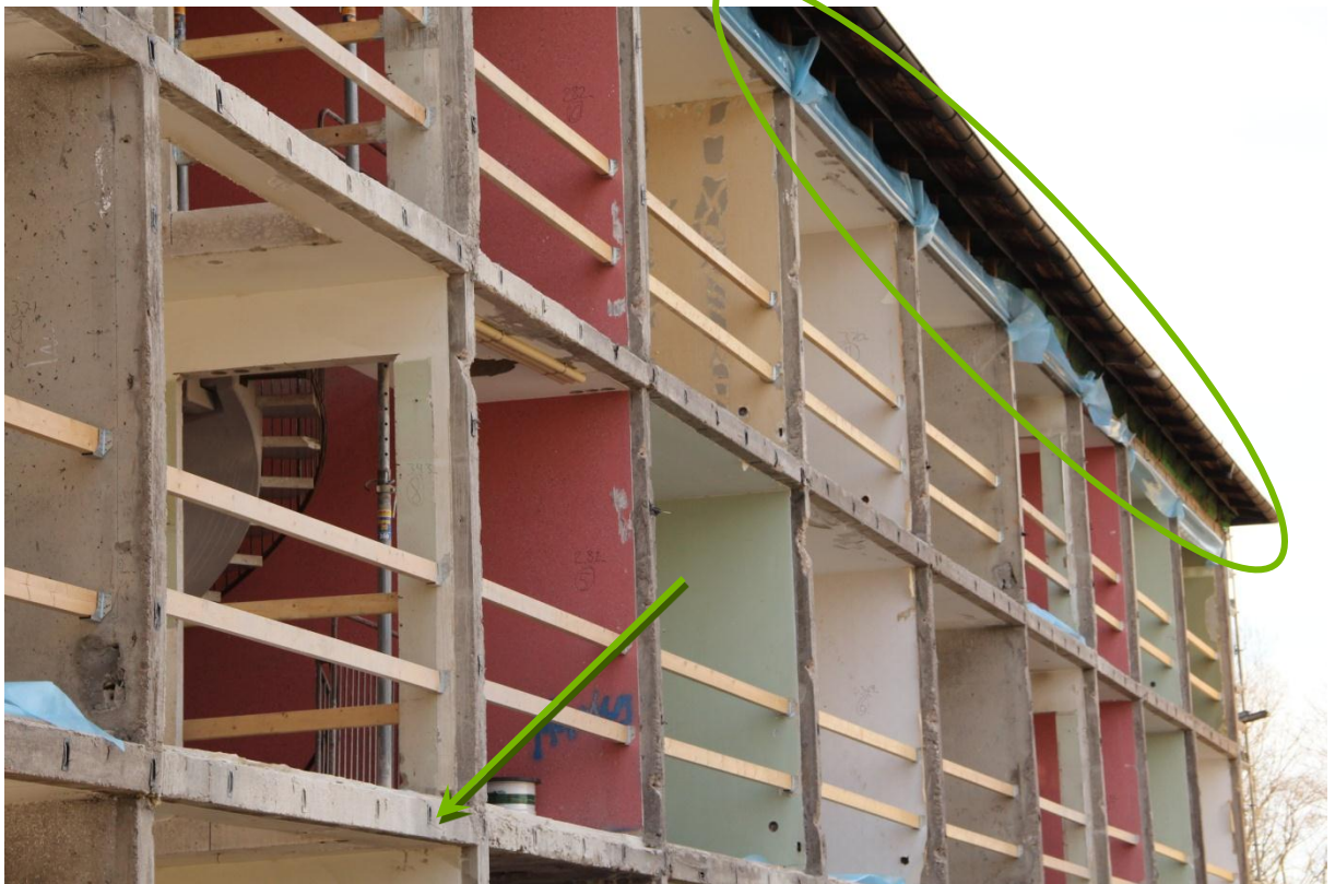
Figur 10 Betongstommen Hus N före väggmontage. Bjälklagen på våning 2 och 3 har täckts av plastfolie för att förhindra uppfuktning av den gamla betongen under öppettiden (plastfolien på vindsbjälklagets undersida, inringad, var ett försök att förbereda för invändigt montage som senare förkastades). Notera fallskydden av träreglar i balkskor. I vissa av de svarta infästningspunkterna i bjälklagskanterna satt tegelkramlorna kvar efter fasadrivningen (t.ex. vid pil) vilket var ett irritationsmoment, eftersom de kom i vägen för väggmontaget.
