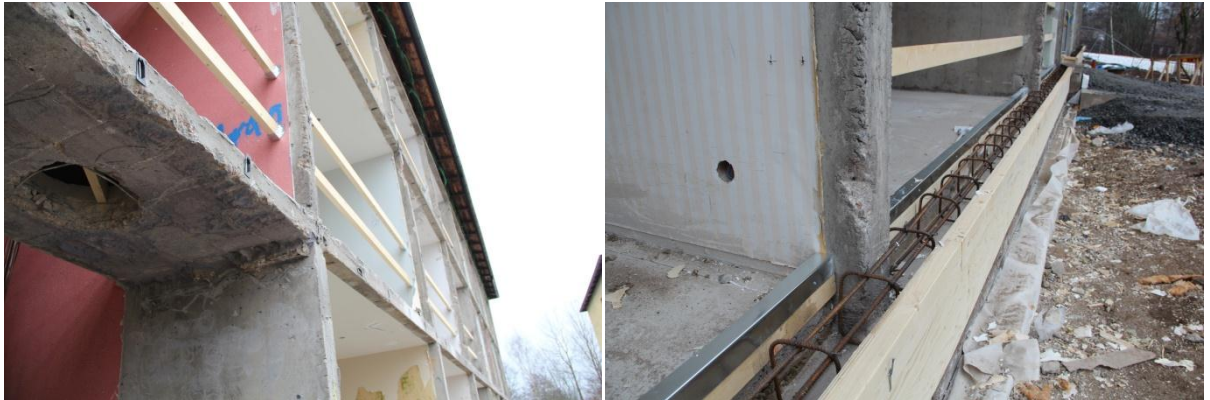
Figur 8 Foton av betongstommen vid skanningstillfället. Tv de råa bjälklagskanterna på västra långsidan. Th: Bottenplattans kantbalk. Eftersom formning av upplaget för väggelementen pågick kunde inte kantbalken skannas. Den ursprungliga kantbalkens läge är dock oviktigt eftersom upplaget gjuts upp i våg till rätt nivå.
