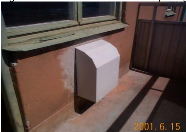
Figur 6.2d Ljudreducerande fasadhuv monterad på tilluftskonvektor till sovrum i provlägenhet med förslag 1
