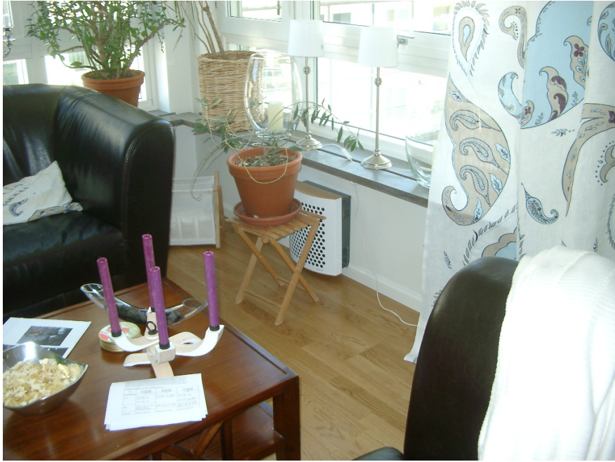
Figur 7.2 Tilluftskonvektor i vardagsrum i provhuset.
