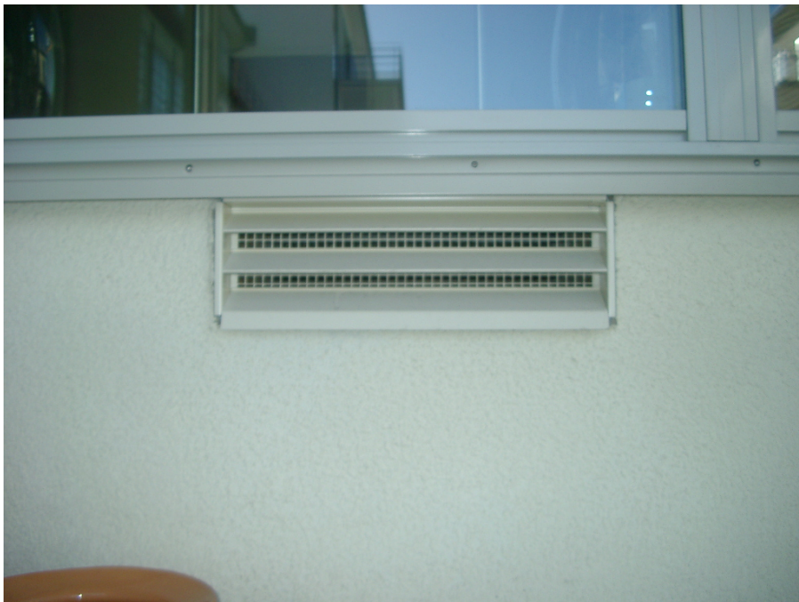
Figur 7.3 Uteluftsintag till tilluftskonvektor i provhuset.
