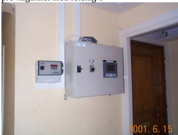
Figur 6.2f Styr- och reglercentral (prototyp) för behovsstyrd ventilation. Centralen innehåller även datalogger för mätningar i provlägenheten med förslag 1.
