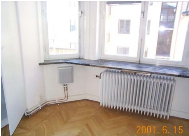
Figur 6.2b Tilluftskonvektor och radiator i stort sovrum
