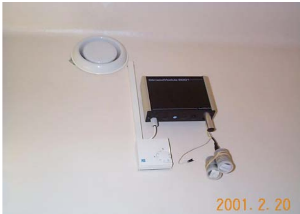
Figur 6.8b Rumstermostat och fuktgivare (prototyp) för styrning av frånluftsdon, i badrum i provlägenhet med förslag 5.
