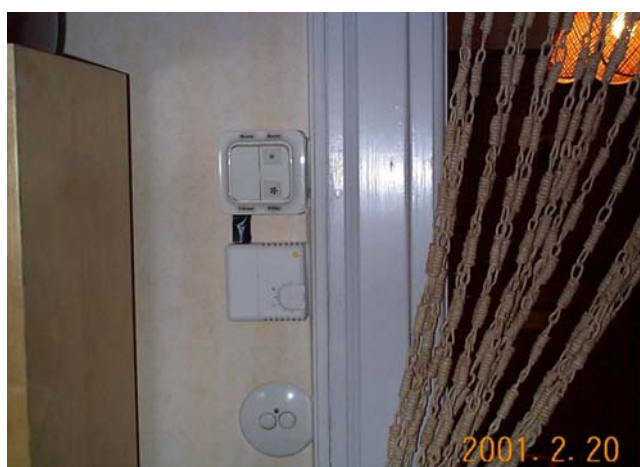
Figur 6.8a Rumstermostat och reglage för borta-hemnaventilation i provlägenhet med förslag 5.
