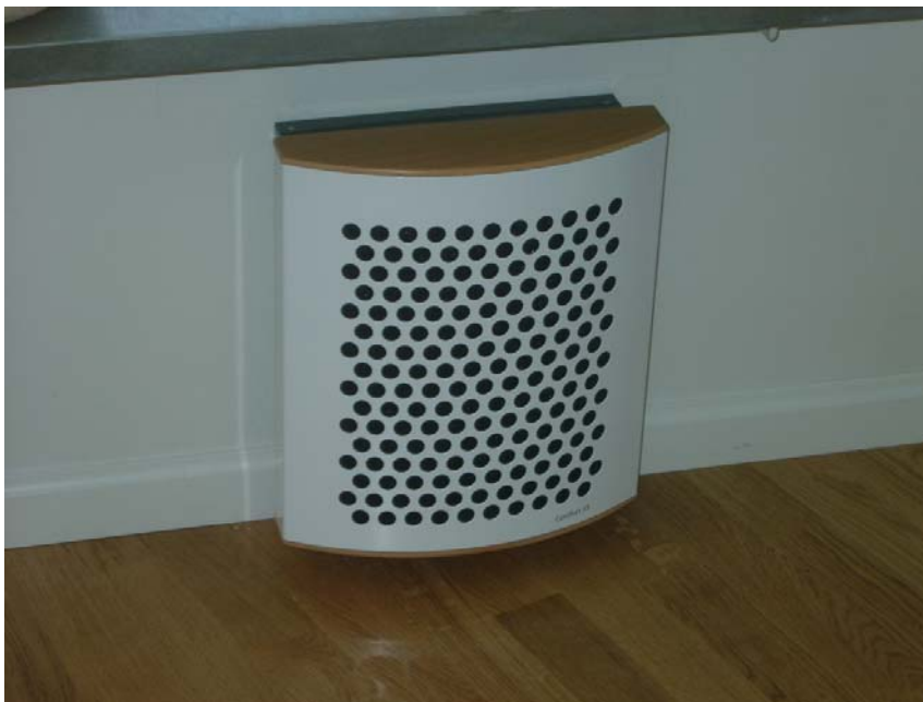
Figur 7.1 Tillufts-konvektor i vardagsrum i provhuset.
